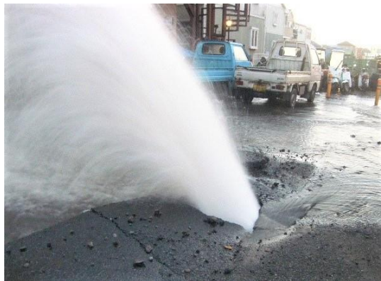
(道路面からの漏水噴出状況)
