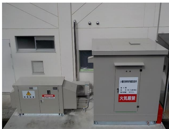
【図 15】 非常用発電機
