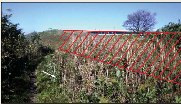
▲断面不足の堤防（神奈川県高座郡寒川町一之宮地先）
