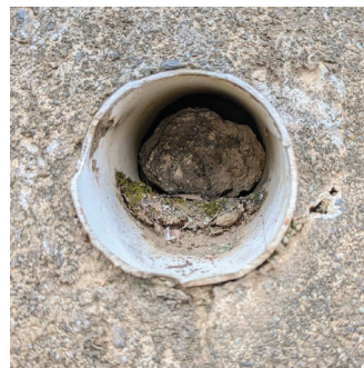
土砂の詰まり
