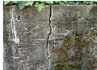
開いた亀裂（表面）
