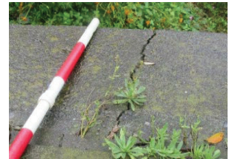
開いた亀裂（頭部）
