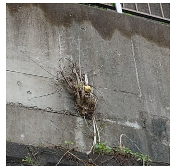
水抜き穴から植物
