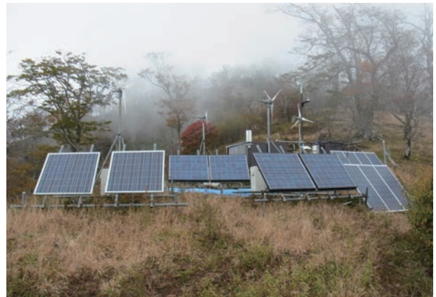
■写真20 大気・観測施設(檜洞丸)
