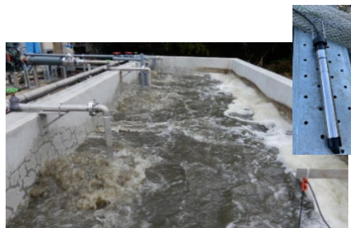
スマート技術を取り入れた浄化槽のばっ気制御技術の開発
