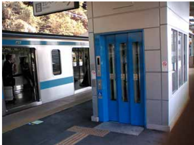
駅に設置されたエレベーター
