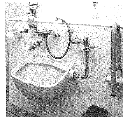
パウチ等の洗浄装置(温水対応)と汚物流し
