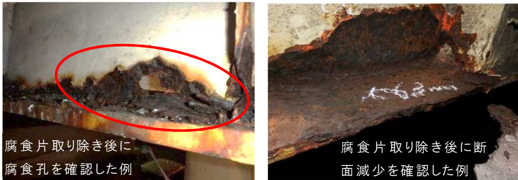
腐食片を取り除いた状態の例（主桁）
