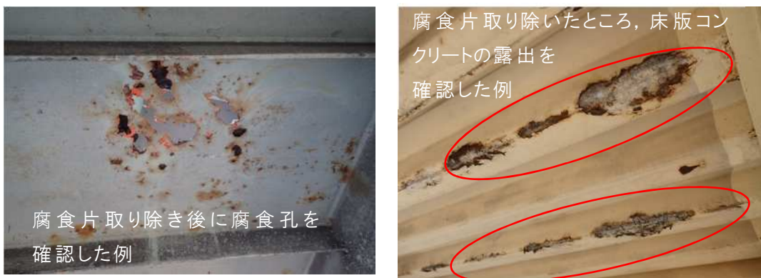
腐食片を取り除いた状態の例（床版）
