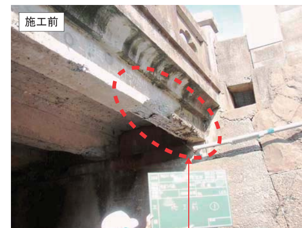
コンクリートが剥離
