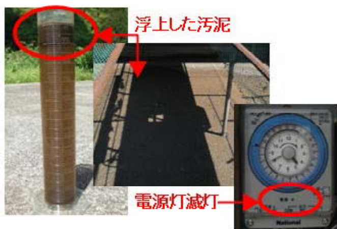
写真5 主電源ダウンによる曝気停止
