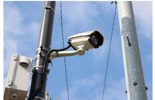
<県補助事業により設置した防犯カメラ>
