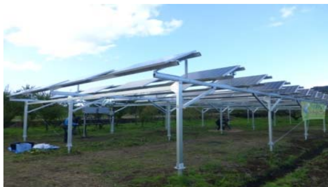
太陽光発電の設置例（ソーラーシェアリング）
