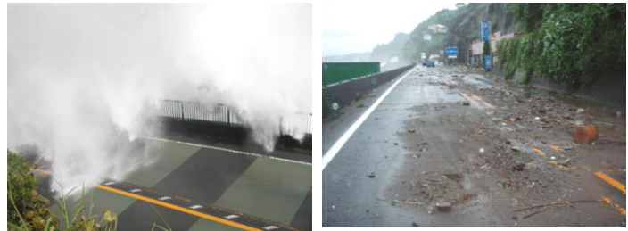
平成19年台風9号による越波被災状況
