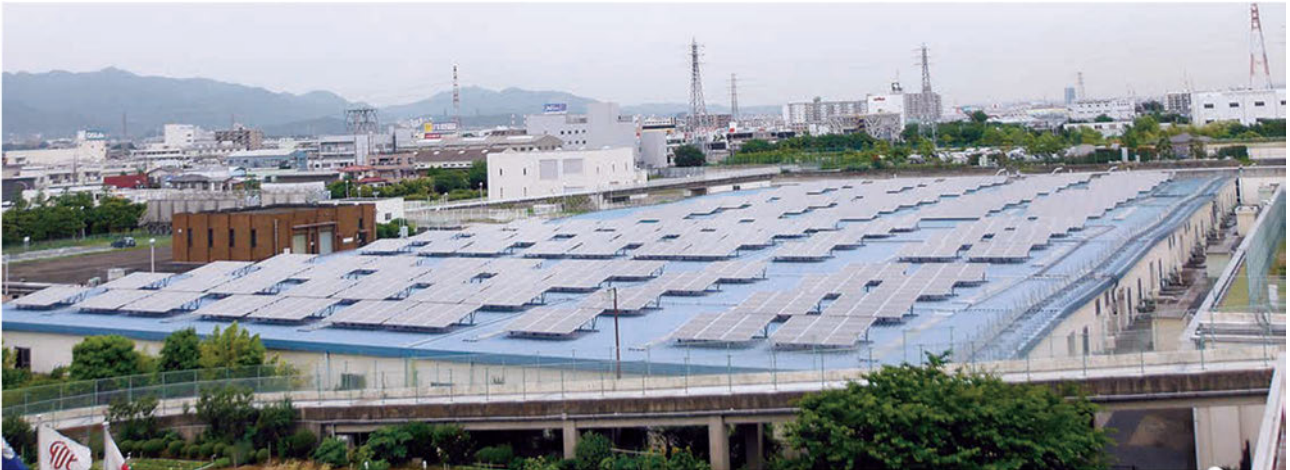
太陽光発電設備
