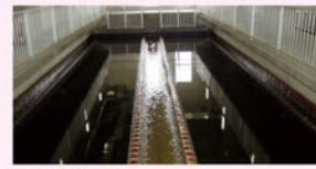
7 最終沈殿池 最終沈殿池で水をゆっくり流すと、綿のようなかたまりとなった活性汚泥が、水の底に沈み、水はすっかりきれいになります。沈んだかたまりは反応タンクへもどされ、ふたたび下水の浄化に利用されます。なお、汚れを食べて増えた活性汚泥は余剰汚泥といい、汚泥濃縮設備へ送られます。
