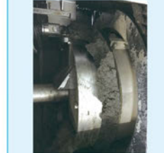
11 汚泥脱水設備 濃縮された汚泥に薬品が加えられて、さらに水分がしぼりとられ、固形物となります。この脱水された汚泥を脱水汚泥といいます。
