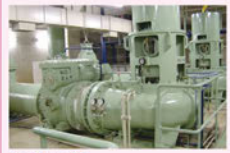
4 ポンプ室 地下深く流れてきた下水を水処理施設に送るため、必要な高さまでくみ上げます。
