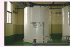
8 消毒施設 きれいになった水を消毒します。
