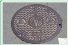
1 マンホール 下水管の点検や清掃をするための入口です。
