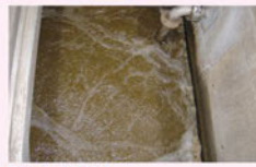
6 反応タンク さらに水をきれいにするため、活性汚泥という微生物の混ざった泥を加えて、反応タンクの底から空気を送り込みます。微生物は下水の汚れを食べて繁殖し、綿のようなかたまりとなって沈みやすくなります。
