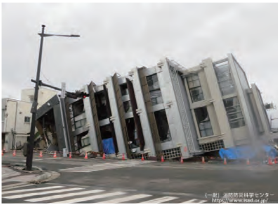
地震により倒壊したビル（令和6年）
