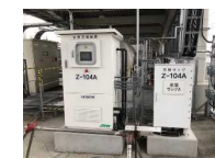
水素充填ユニット
