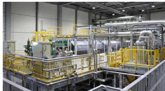
10MWの水電解装置
