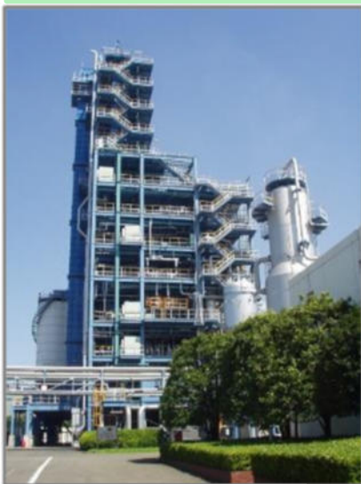
昭和電工川崎事業所 (ガス化プラント)
