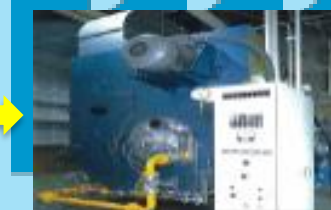
既設ボイラー
