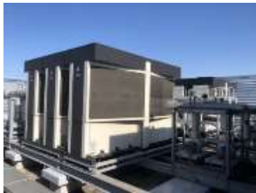
冷暖チリングユニット 6台
