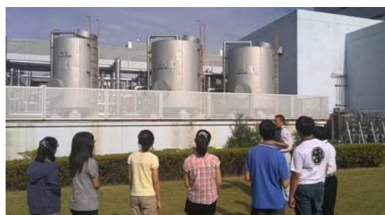
海水を浄化する巨大ろ過槽を見学しました。
