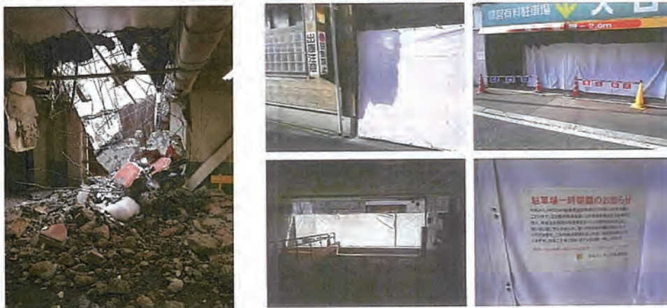
崩落箇所もあり、危険と判断し、駐車場を閉鎖しました
