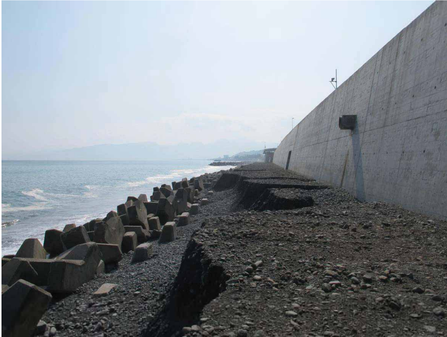
図-25 西湘バイパスの国管理区間前面での盛り土養浜（2014年5月2日） 土砂が流出し、高い浜崖が形成されている。
