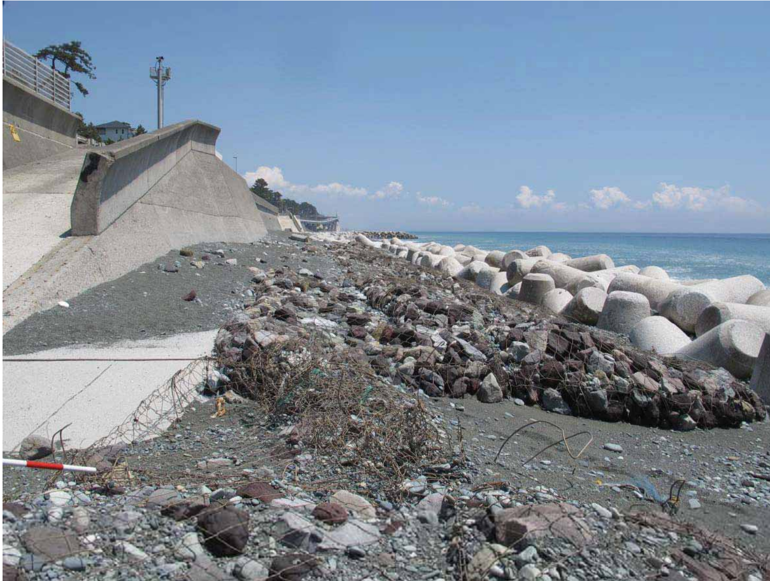
図-22 二宮海岸における破壊された鉄線籠(2012年5月2日) 海岸が汚らしくかつ危険。
