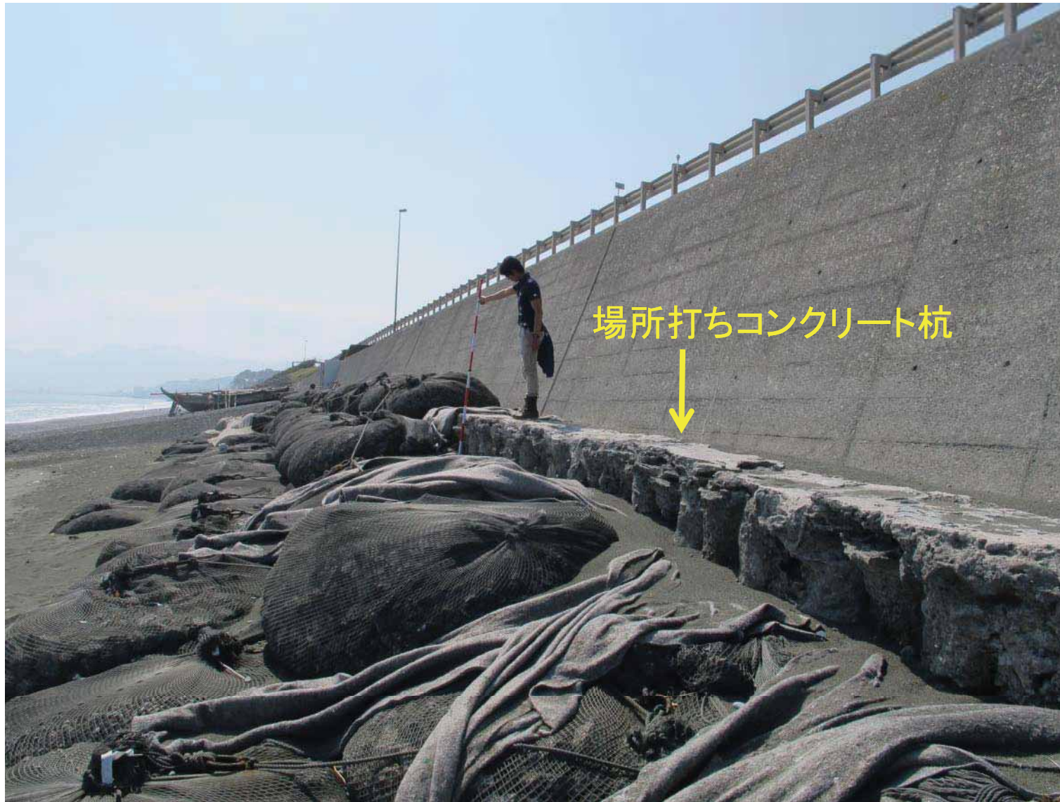
図-23 侵食されて露出した場所打ちコンクリート杭（2014年5月2日） フィルターユニットは場所打ちコンクリート杭の頭部に並べられていたが、 高波浪の作用により落下した。
