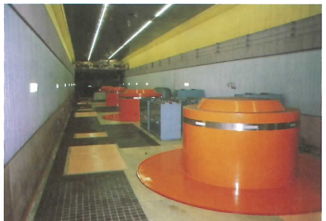
▲城山発電所にある地下230mの発電き室
